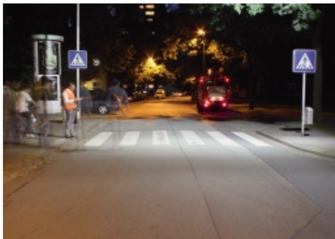
↓ Eine asymmetrische LED-Leuchte mit 60W Anschlussleistung sorgt für die normgerechte Ausleuchtung dieses Fußgängerüberwegs in Hannover.
